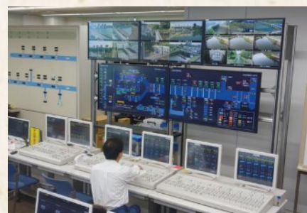
遠方監視システムの導入による 合理的な水管理の実施 （水資源機構見沼管理所）
